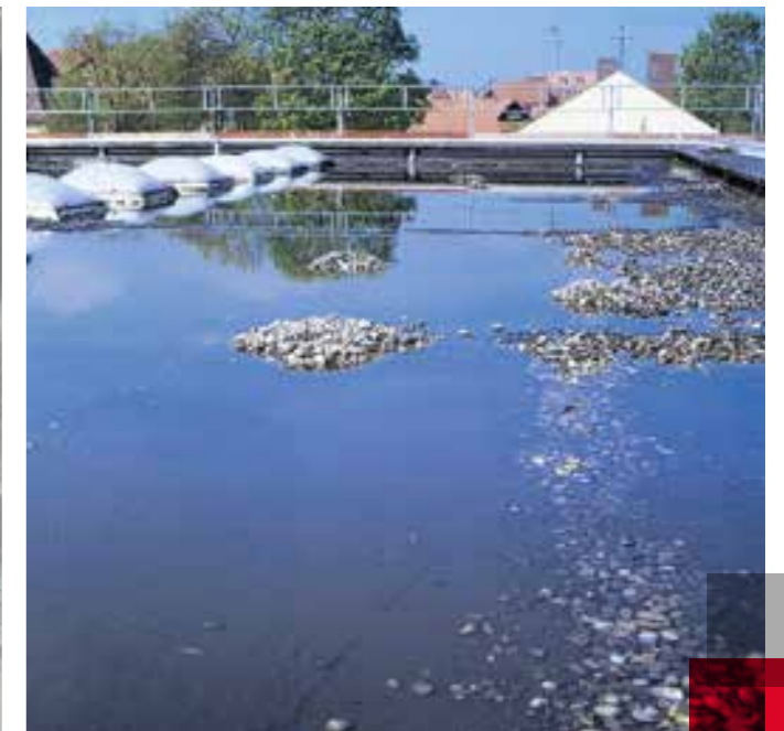
Stehendes Wasser auf einem Null-Grad-Dach
