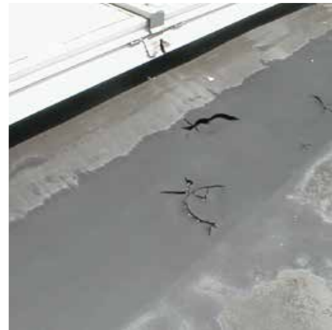
Materialschäden erfordern eine Dachsanierung
