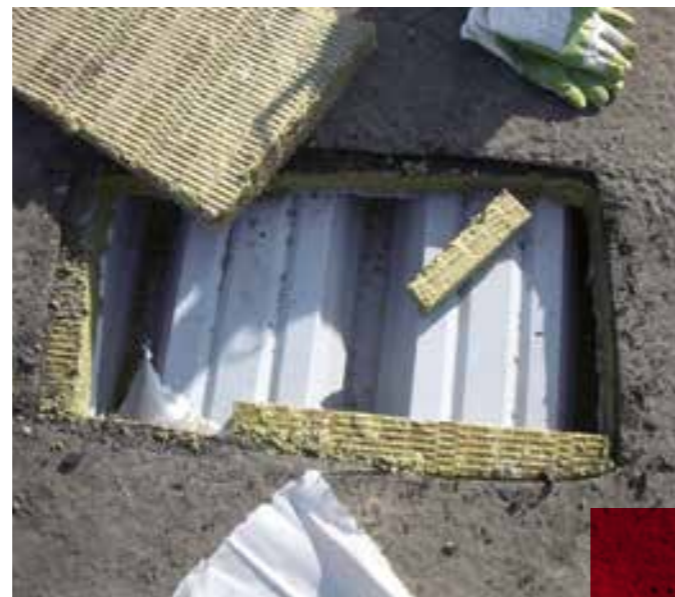
Bei Undichtigkeiten Dämmstoff auf Feuchtigkeit überprüfen
