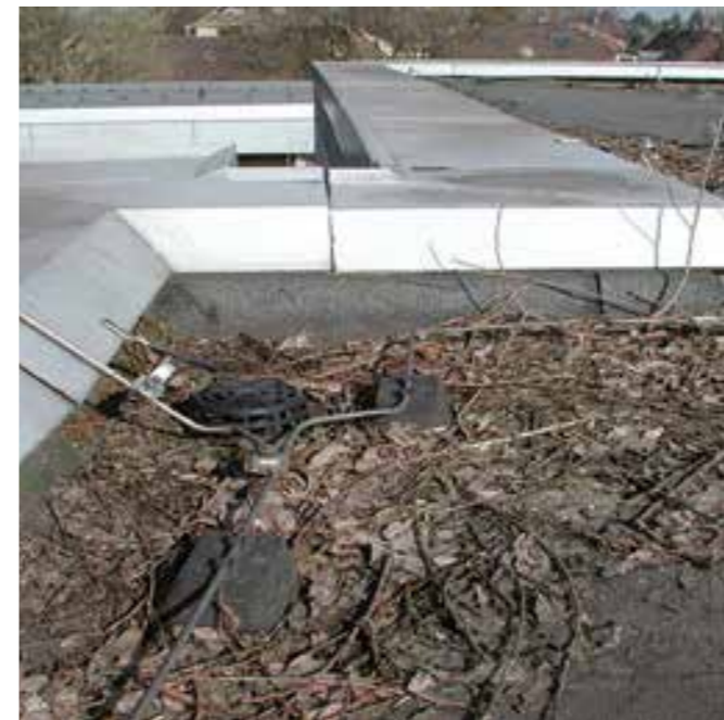
Regelmäßige fachgerechte Wartung verhindert Folgeschäden
