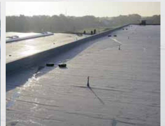
Punktentwässerung entlang der Attika
