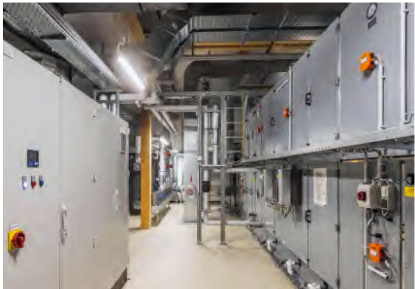
↑ Die leistungsstarke Lüftungstechnik ist über der Küche im Nebengebäude untergebracht.
